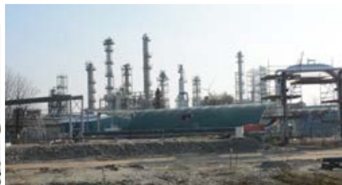
Foto 2018: ook vandaag wordt er nog gewerkt met op de voorgrond de pijpleidingen van Ecluse
